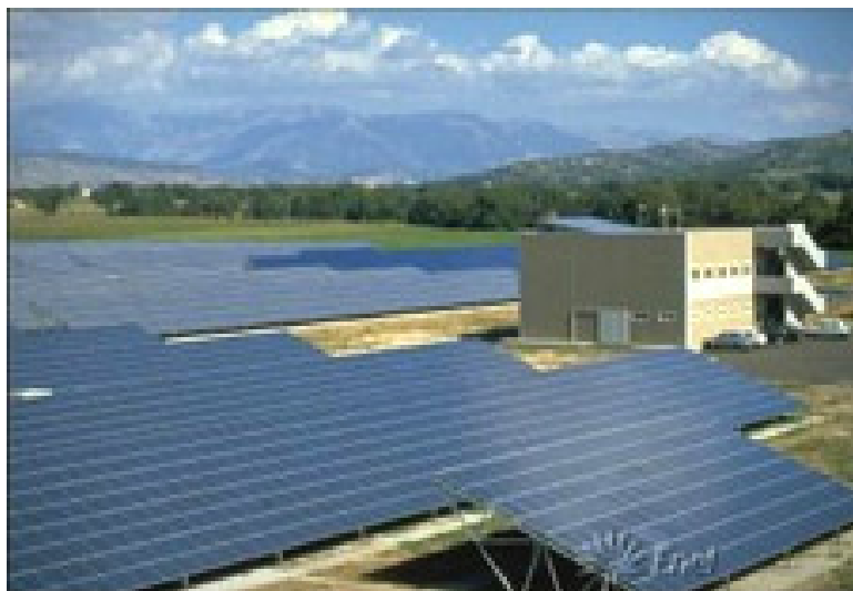
Fig. 6. La centrale ENEL di Serre
